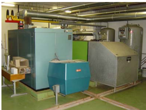
Heizzentrale Schulanlage Neumatt, Februar 2006
